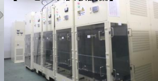
【EVヒューズ試験設備】
